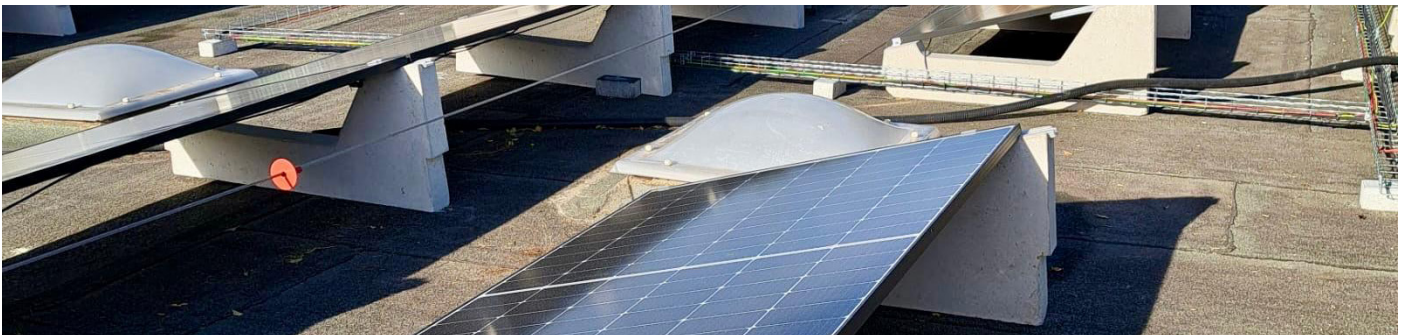
Placas solares en el tejado de la Casa de la Música
