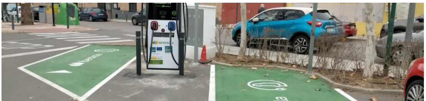
Cargadores eléctricos en plazas de aparcamiento públicas
